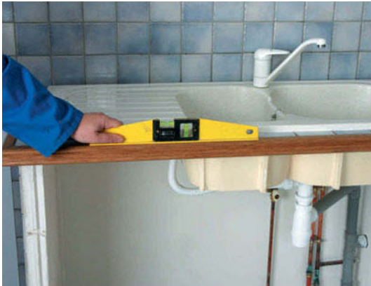
Vérifiez le niveau des surfaces horizontales.
